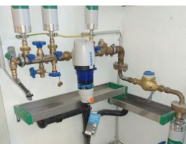
Beispiel einer gut gewarteten Sanitärverteilung
